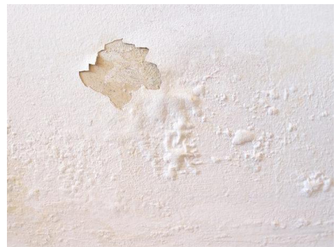
Slika 2: luščenje barve zaradi vodnega pritiska
