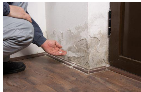
Slika 1: luščenje ometa zaradi vodnega pritiska
